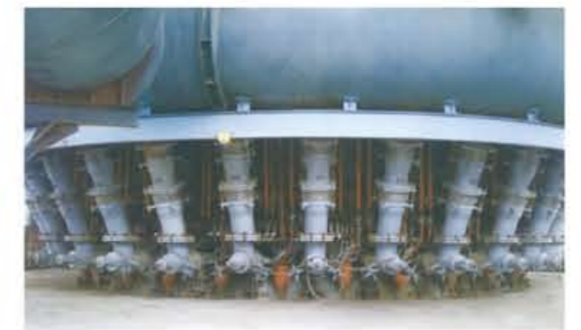
3200m³ 高炉送风装置使用现场 3200m³ Blast Furnace Air Supply Device use Site
